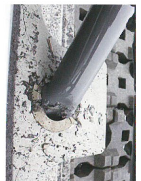
1本目のひび割れ状況
