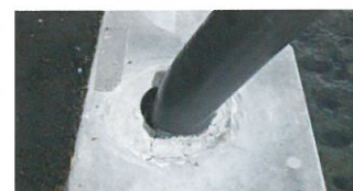
縦断方から見た支柱の変位状況
