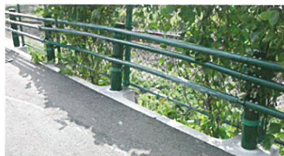
衝突した後の状況
